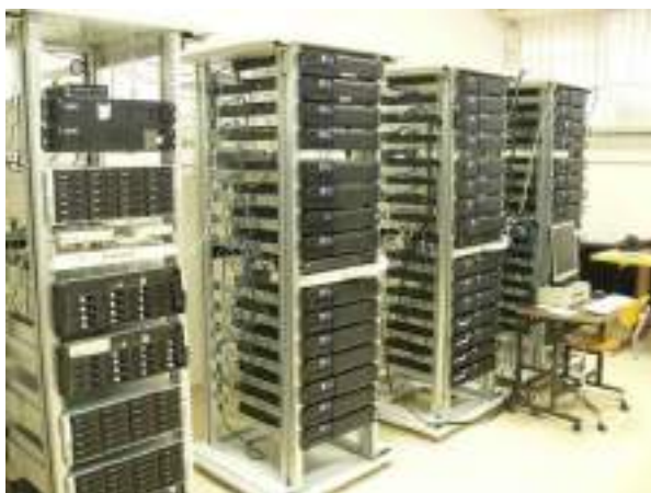
Obr. 4.4 Časť počítačového centra WLCG na FMFI UK Bratislava
